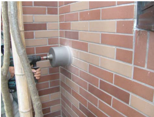
・外壁の穴あけ状況
